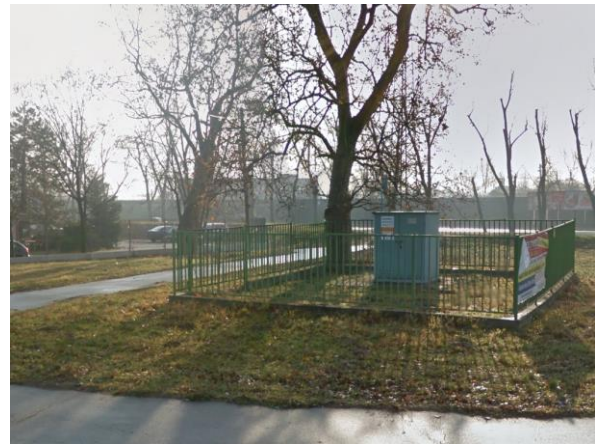
Lemezház nagyközép/növelt kisnyomású gáznyomásszabályzó a Városház utca mellett (forrás: maps.google.com)
